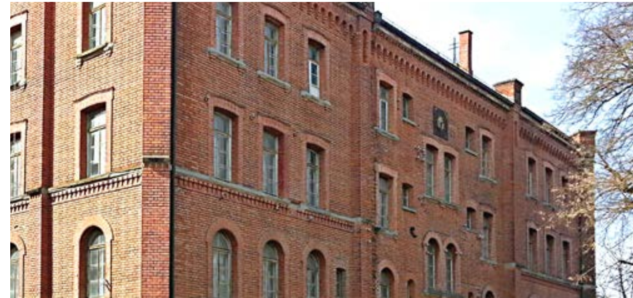
Die historische Fassade des Roten Baus besteht aus stark verwitterten Steinelementen.
